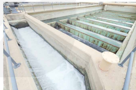
Hình 6.1. Các bể xử lý ở nhà máy nước
